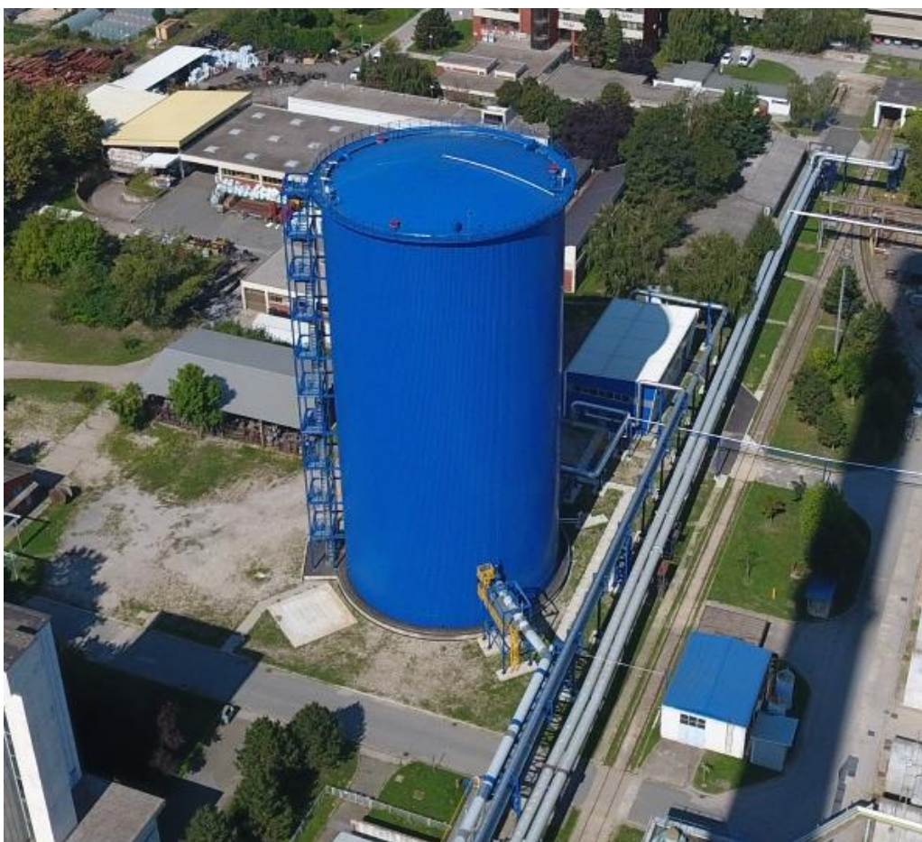
Slika 7. Toplinski akumulator TE-TO Zagreb; [17]
