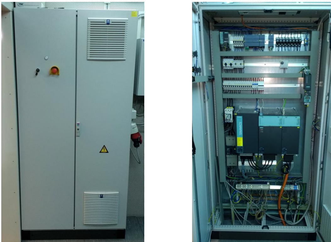
Slika 4.3 Razvodno-upravljački ormar RO1
