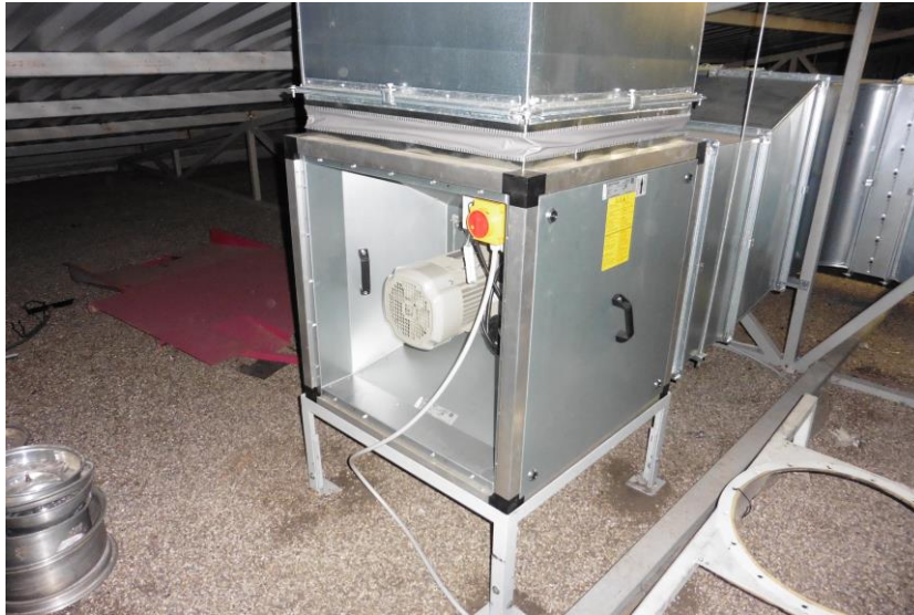
Slika 3.6 Postojeći ventilator za odvođenje zraka
