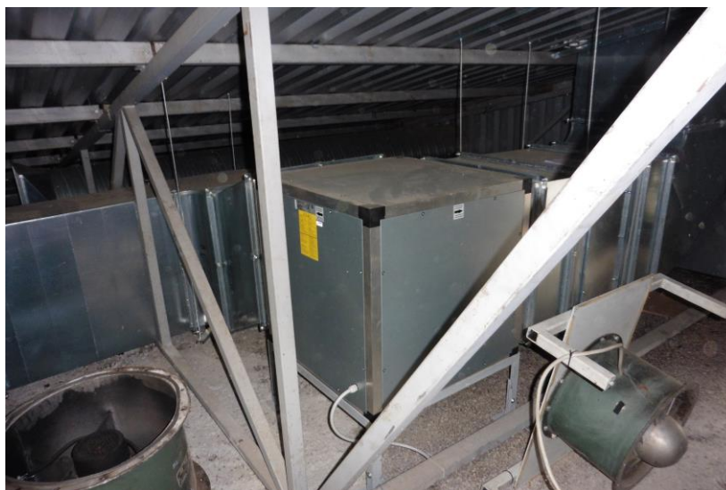
Slika 3.5 Postojeći ventilator za dovođenje zraka
