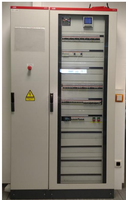
Slika 4.10 Razvodni ormar RO2
