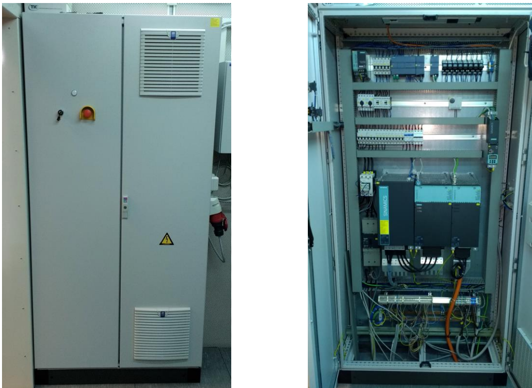
Slika 4.3 Razvodno-upravljački ormar RO1
