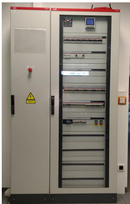
Slika 4.10 Razvodni ormar RO2
