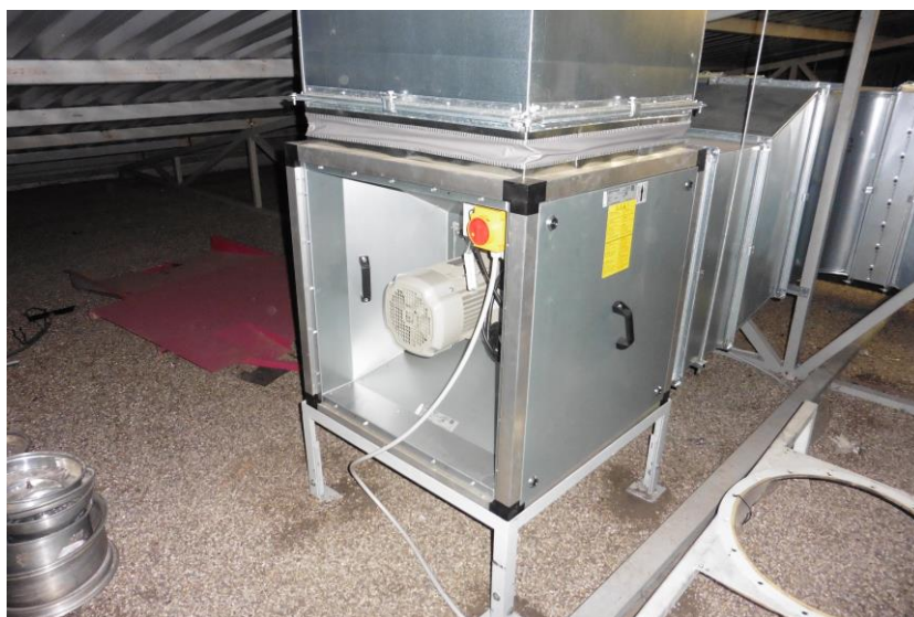
Slika 3.6 Postojeći ventilator za odvođenje zraka
