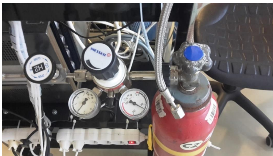
Slika 30. Spremnik i ventili za otpuštanje vodika
