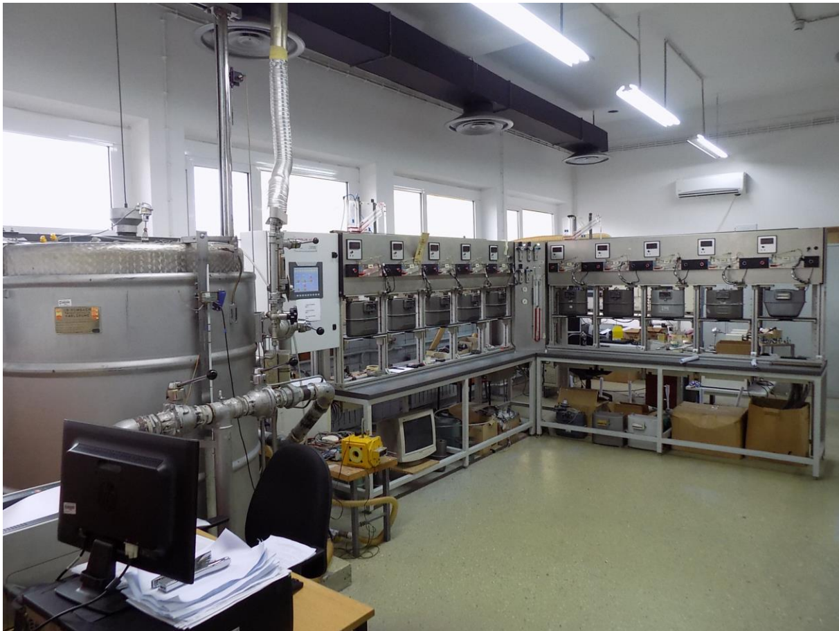
Slika 17 Sustav sa ispitnim zvonom u Gradskoj plinari Zagreb
