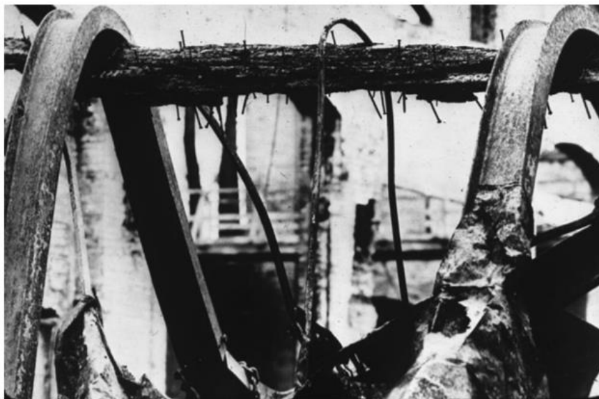
Slika 3.15. Drveni i čelični nosači nakon požara [4]
