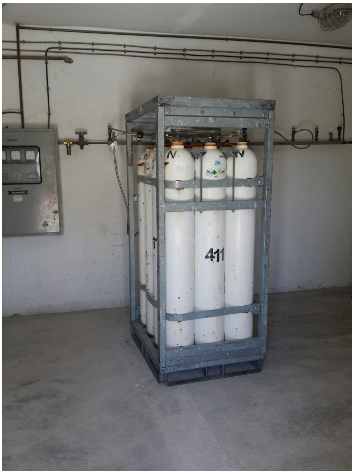
Slika 25. Razvodni sustav za kisik
