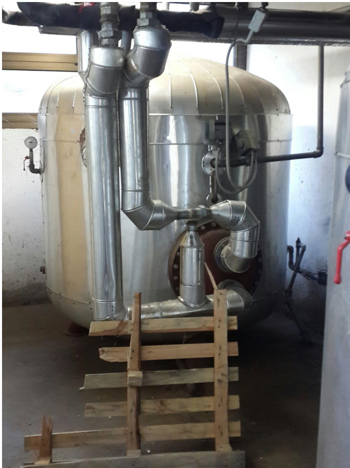
Slika 20. Glavni bojler u kotlovskom postrojenju
