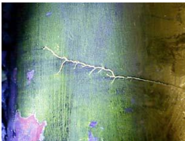
Slika 25: Indikacija pukotine prikazana fluorescentnim penetrantom [20]
