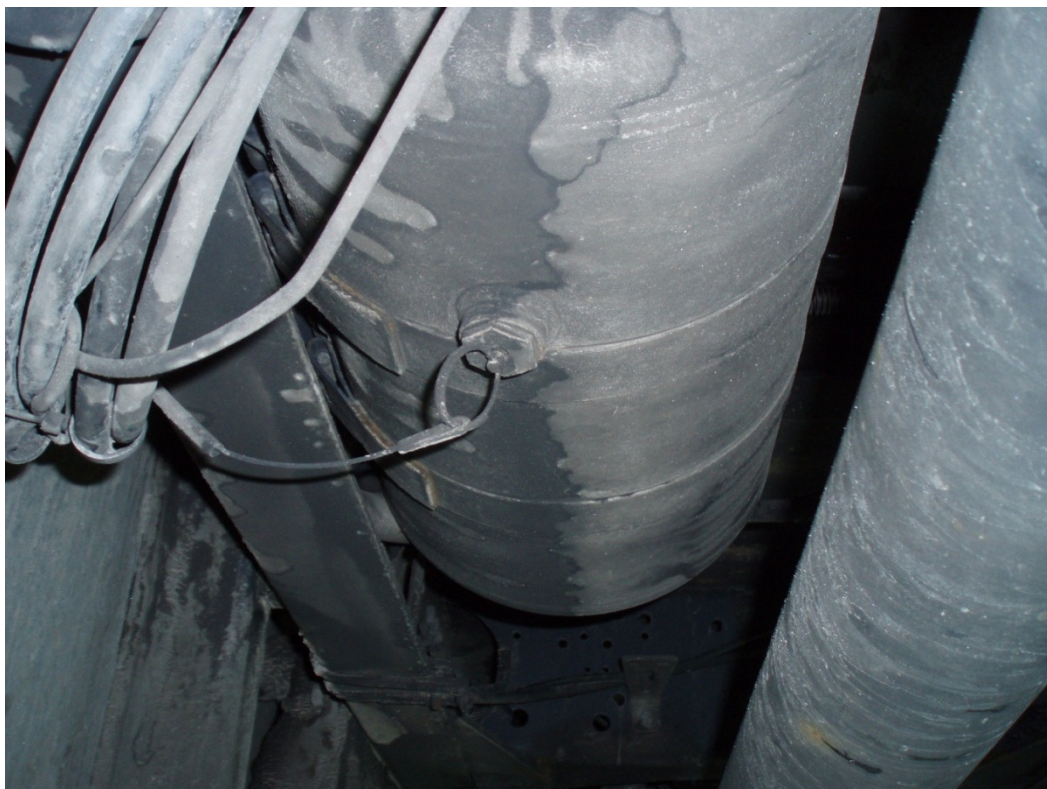
Slika 10.3 Spremnik zraka s ručnim ventilom za ispuštanje kondenzata
