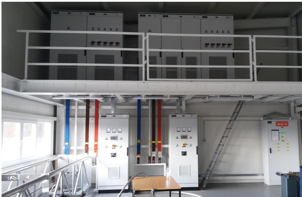
Slika 6. Oprema za električna ispitivanja
