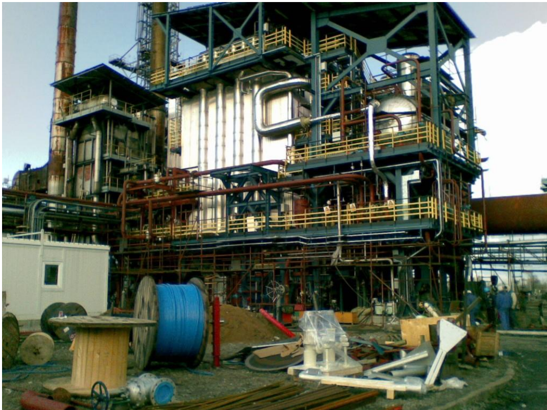
Slika 1 Generator pare u INA Rafineriji nafte Sisak
