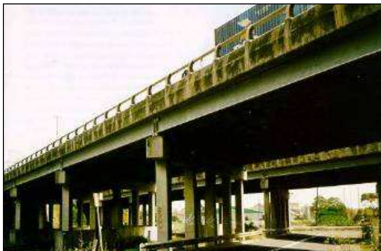
Slika 29. Most zaštićen vodorazrijedivim premazom [12]
