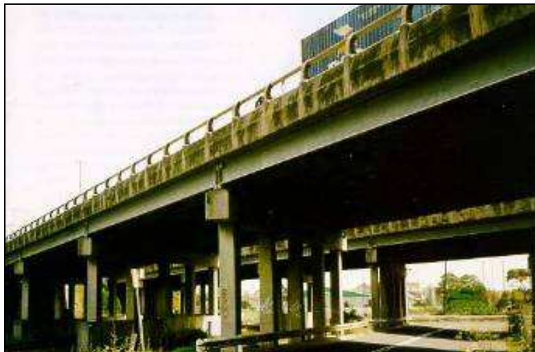
Slika 29. Most zaštićen vodorazrijedivim premazom [12]
