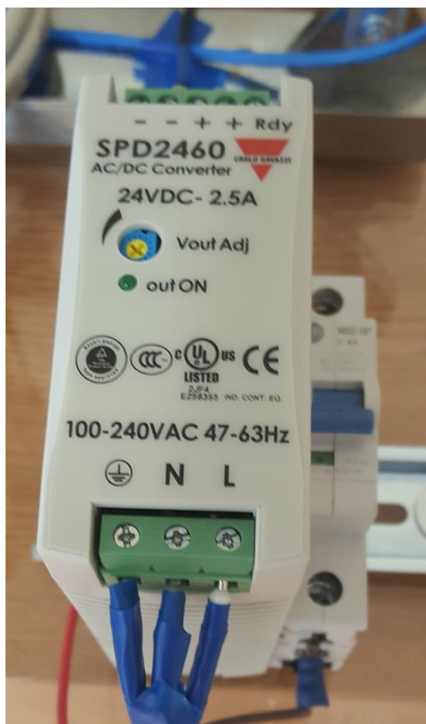
Slika 30. Ugrađeni ispravljač na nastavnoj maketi
