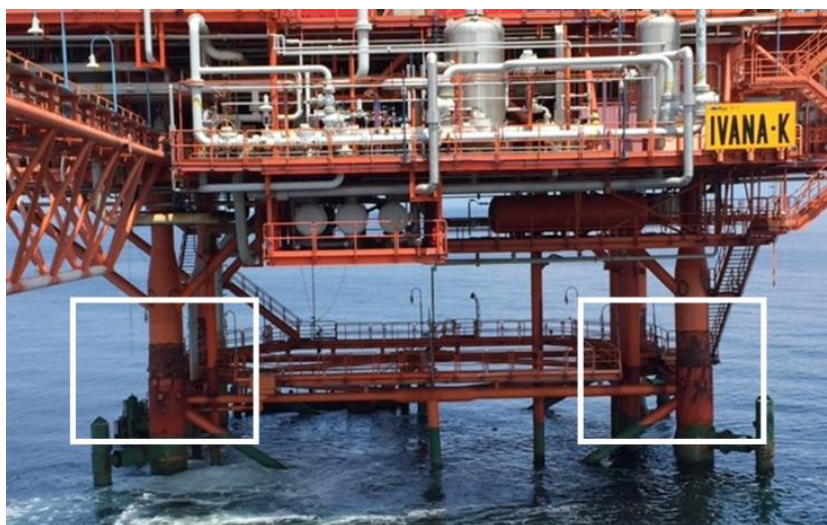
Slika 1. Korozijsko oštećenje na platformi Ivana K [2]
