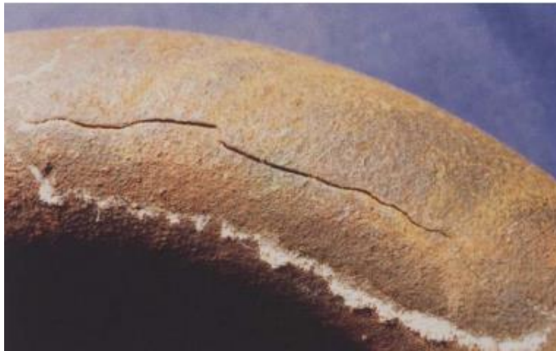
Slika 5. Napetosna korozija na cijevi [6]
