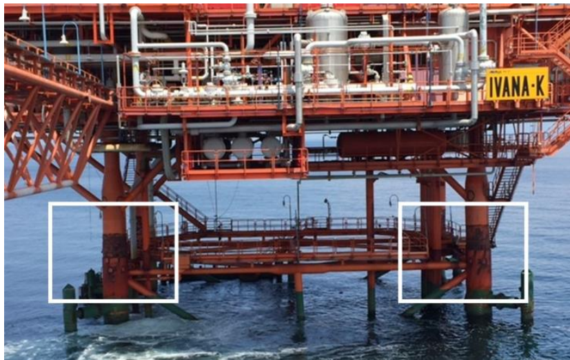
Slika 1. Korozijsko oštećenje na platformi Ivana K [2]
