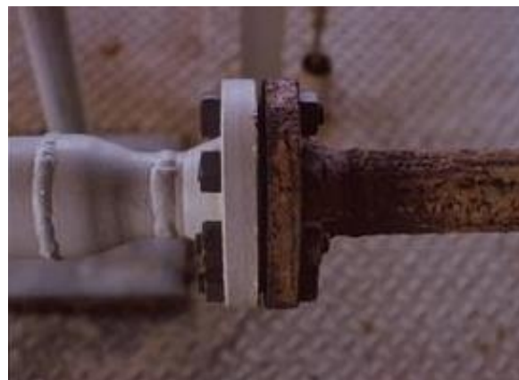
Slika 4. Kontaktna korozija na odobalnom postrojenju [5]
