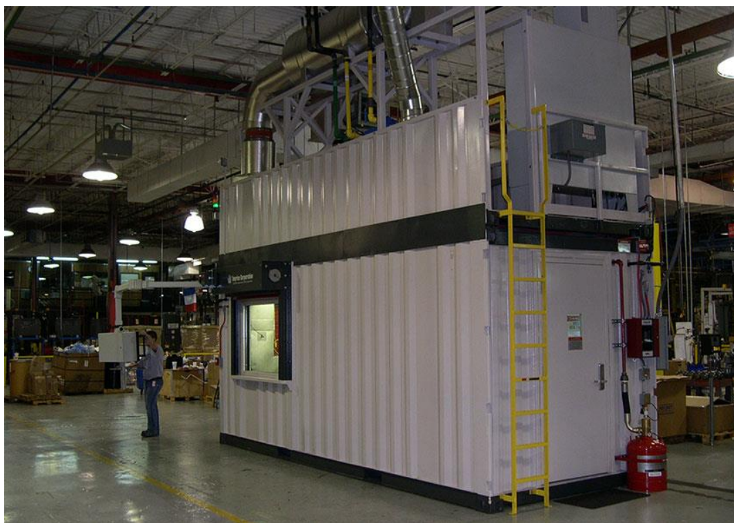
Slika 2.2. Kontejnerska ispitna kabina unutar postojeće građevine [1]
