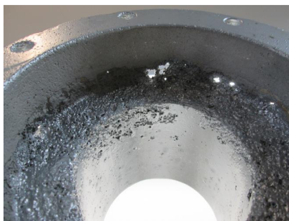
Slika 6. Rupičasta korozija prirubnice [7]
