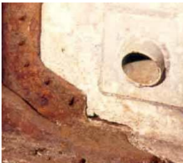
Slika 7. Kontaktna korozija aluminija u dodiru s čelikom [9]
