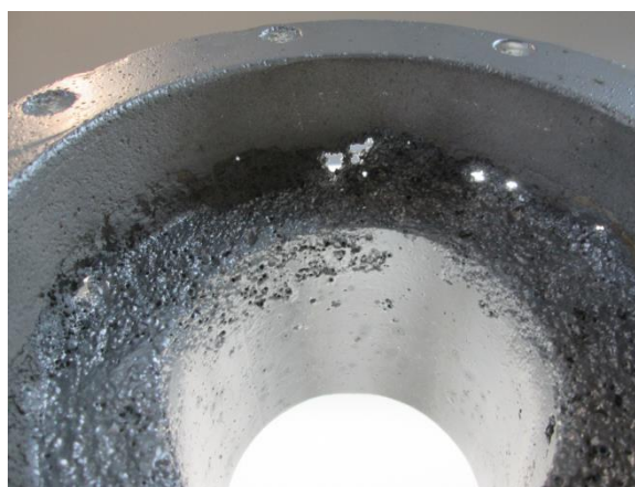
Slika 6. Rupičasta korozija prirubnice [7]
