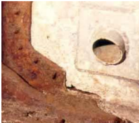
Slika 7. Kontaktna korozija aluminija u dodiru s čelikom [9]
