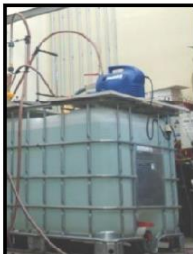
SUSTAV ZA VODENO HLAĐENJE
