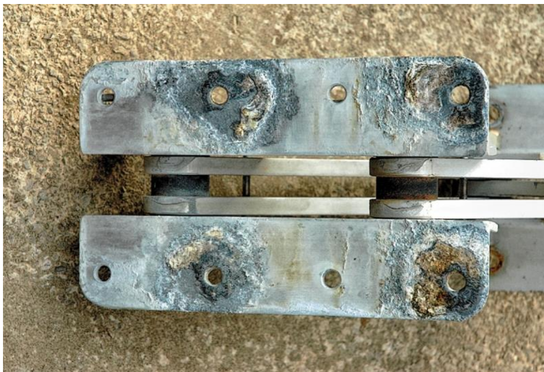
Slika 6. Prikaz galvanske korozije [11]
