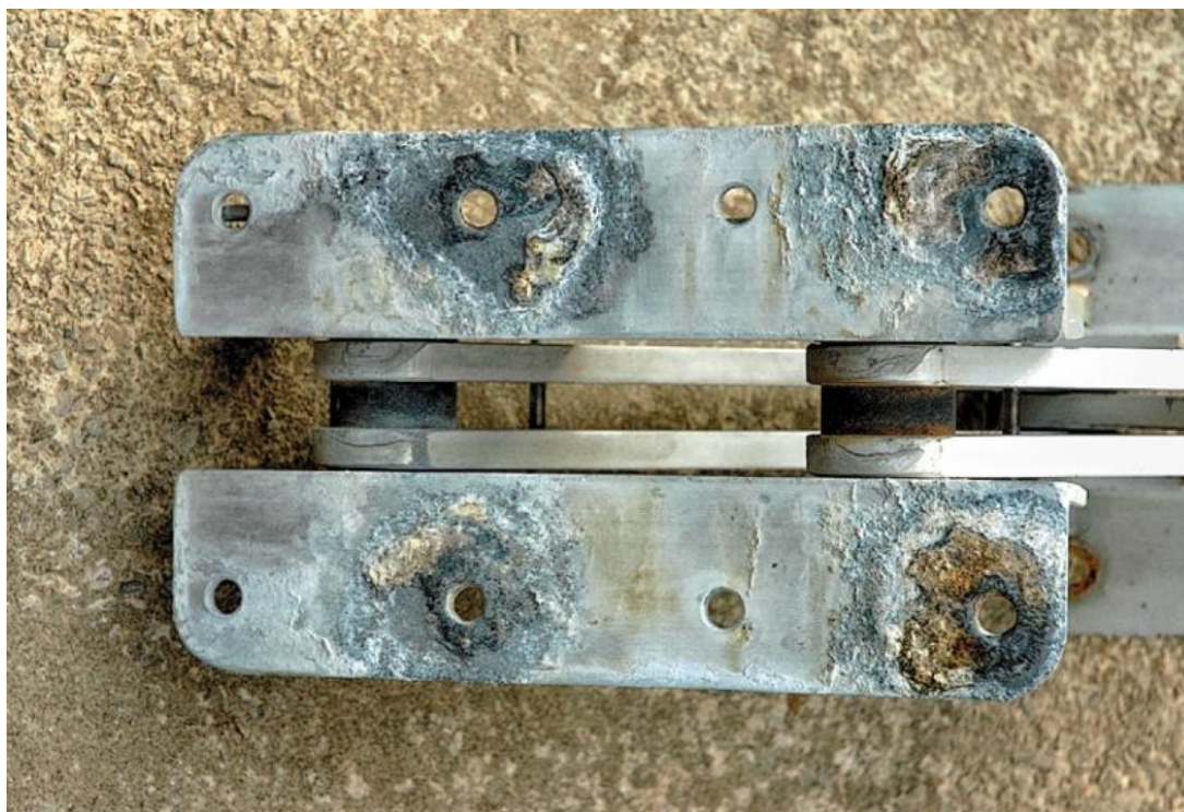
Slika 6. Prikaz galvanske korozije [11]
