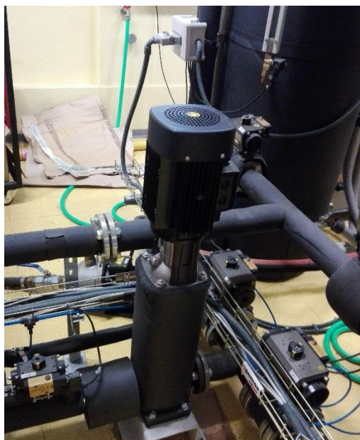
Slika 13. Pumpa za dobavljanje vode iz spremnika
