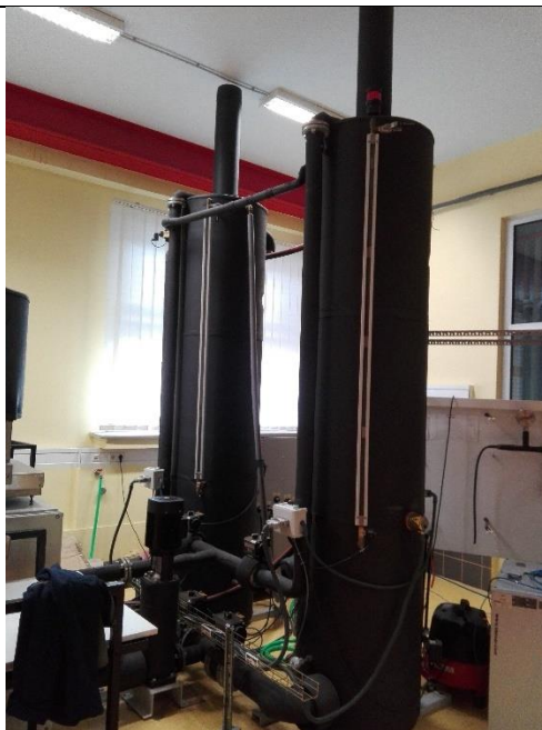
Slika 14. Topli i hladni spremnik vode
