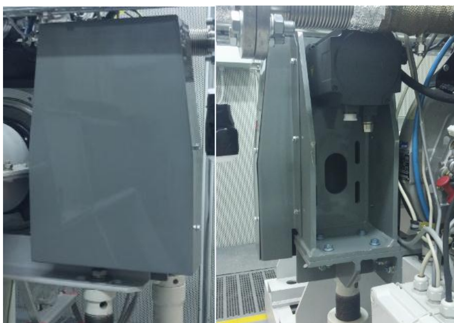
Slika 30. Nosiva konstrukcija sa zaštinim limovima i elektromotorom
