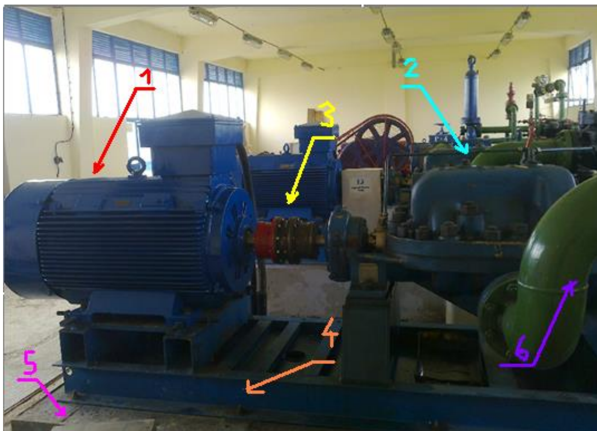
Slika 31. Set elektromotor-pumpa MP1
