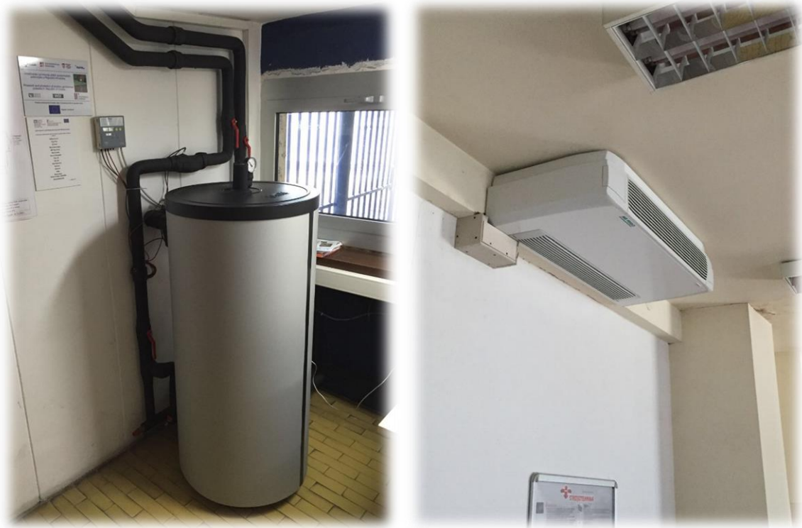
Slika 6-9. Spremnik rashladne vode i ventilokonvektor za hlađenje predavaonica
