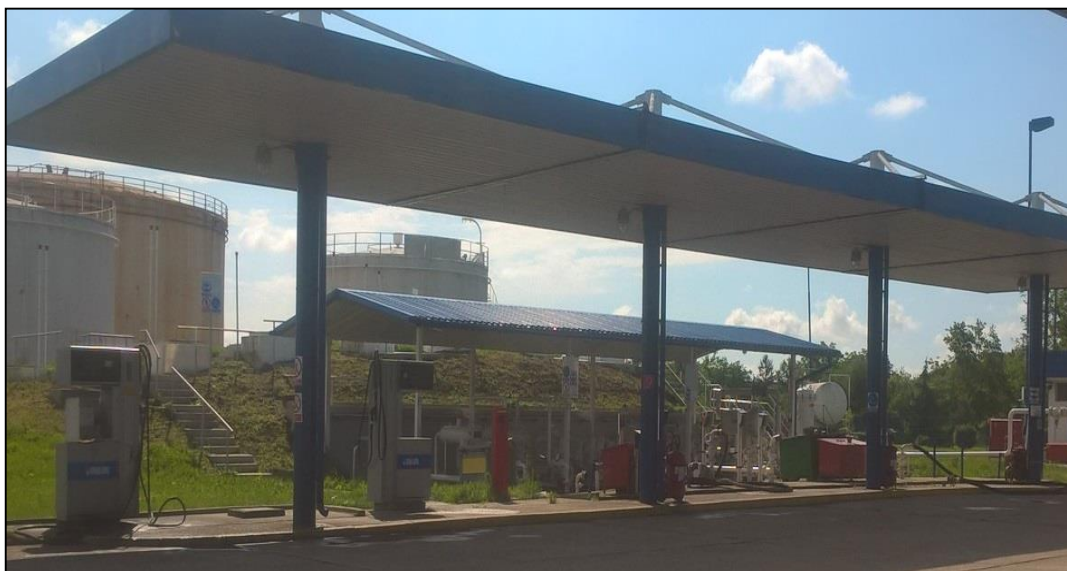
Slika 22. Vanjsko istakalište i punilište na lokaciji OZ Zagreb
