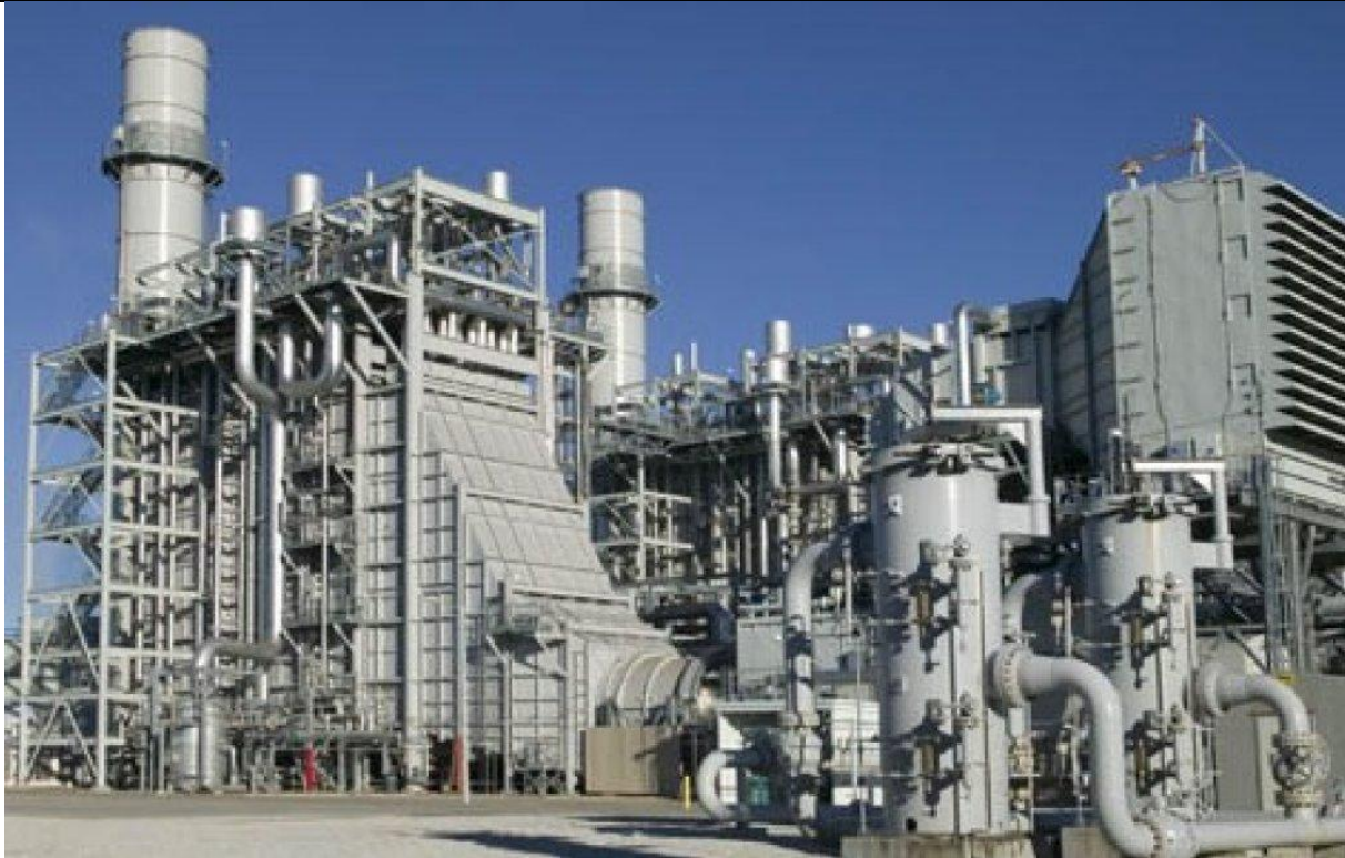
Slika 29. Kotao na otpadnu toplinu (HRSG) [9]
