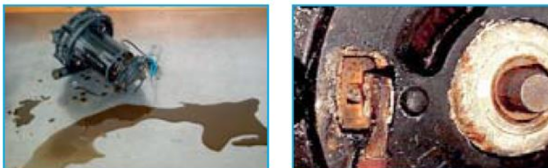
Slika 17. Kondenzat i korodirani električni priključci na pumpi dodatnog zraka [6]
