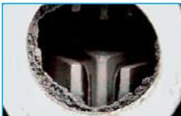
Slika 18. Naslage u nepovratnom ventilu [6]
