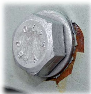
Slika 34. Atmosferska korozija uslijed pucanja premaza [9]
