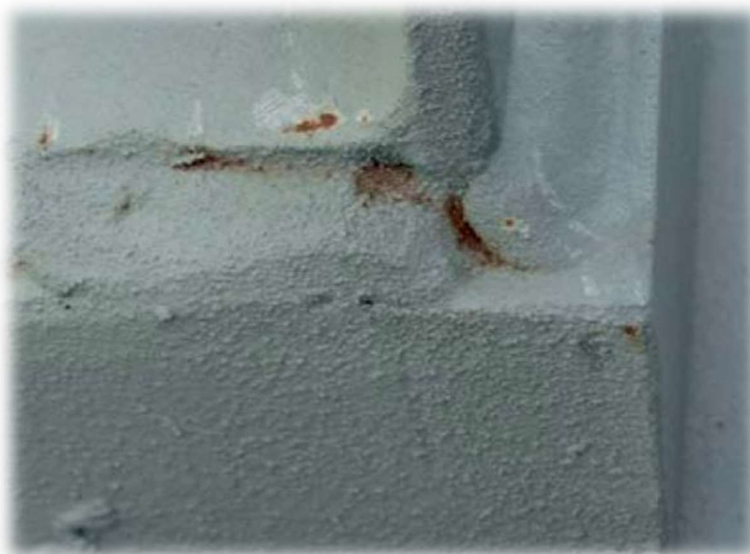
Slika 30. Loše izvedeni zavarivački radovi [9]
