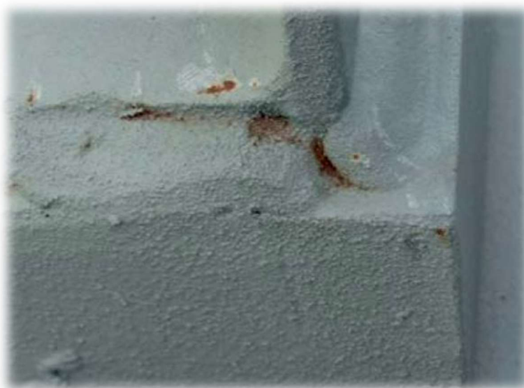
Slika 30. Loše izvedeni zavarivački radovi [9]
