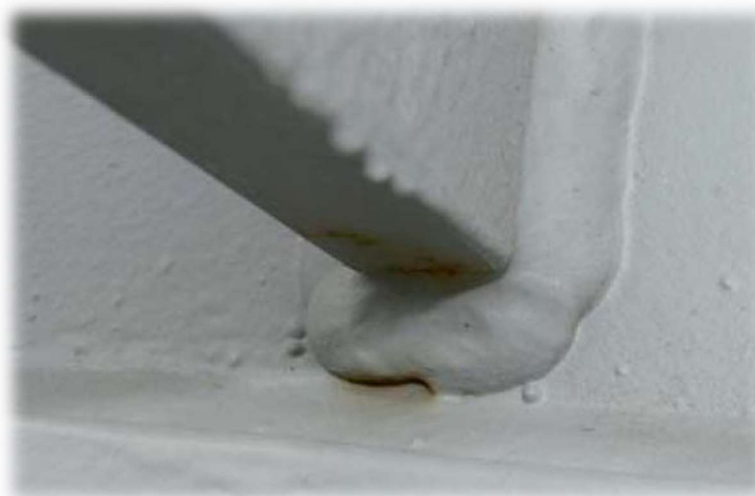
Slika 31. Loše konstrukcijsko rješenje [9]
