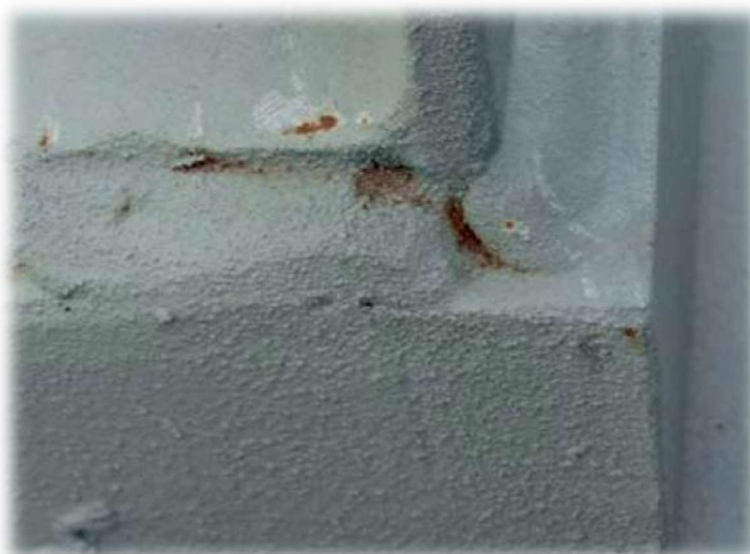
Slika 30. Loše izvedeni zavarivački radovi [9]
