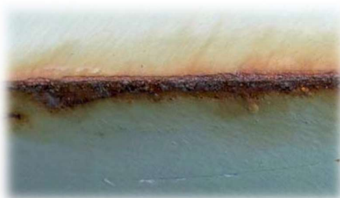
Slika 33. Atmosferska korozija na oštrom bridu [9]
