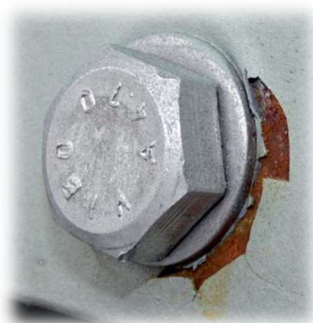
Slika 34. Atmosferska korozija uslijed pucanja premaza [9]
