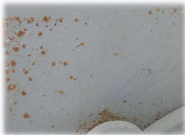
Slika 32. Korozija u procjepu između temelja i dna transformatora [9]
