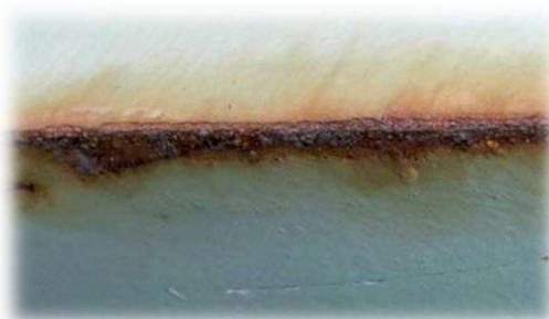
Slika 33. Atmosferska korozija na oštrom bridu [9]
