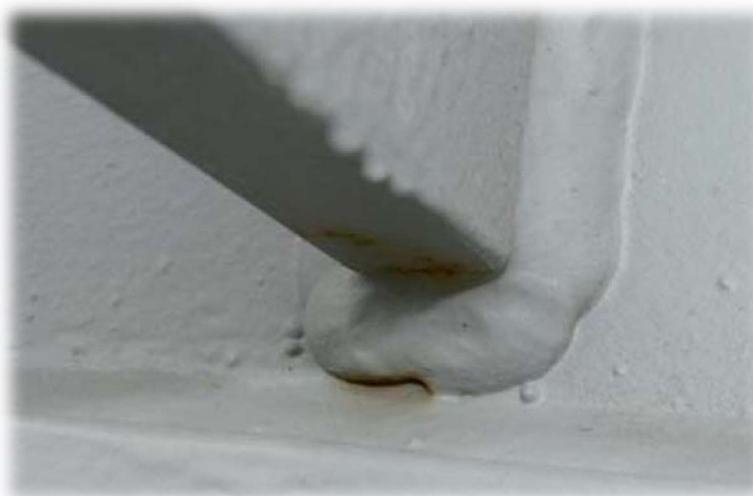
Slika 31. Loše konstrukcijsko rješenje [9]
