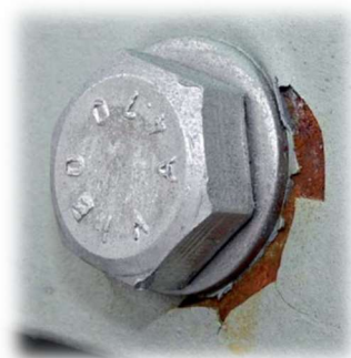
Slika 34. Atmosferska korozija uslijed pucanja premaza [9]
