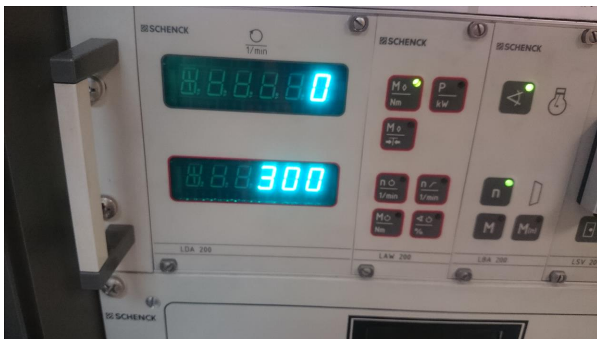
Slika 8.15 Prikaz na digitalnom pokazniku upravljačkog ormara
