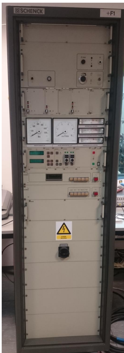
Slika 8.7 Upravljački ormar hidrauličke kočnice
