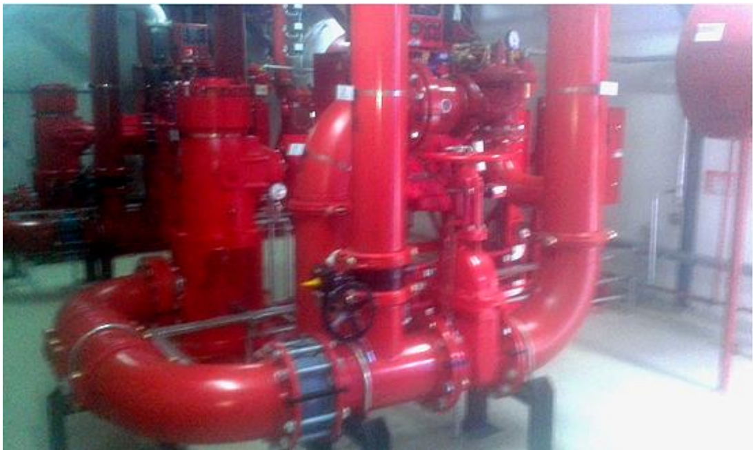
Slika 25. Pumpna stanica pogona SM2
