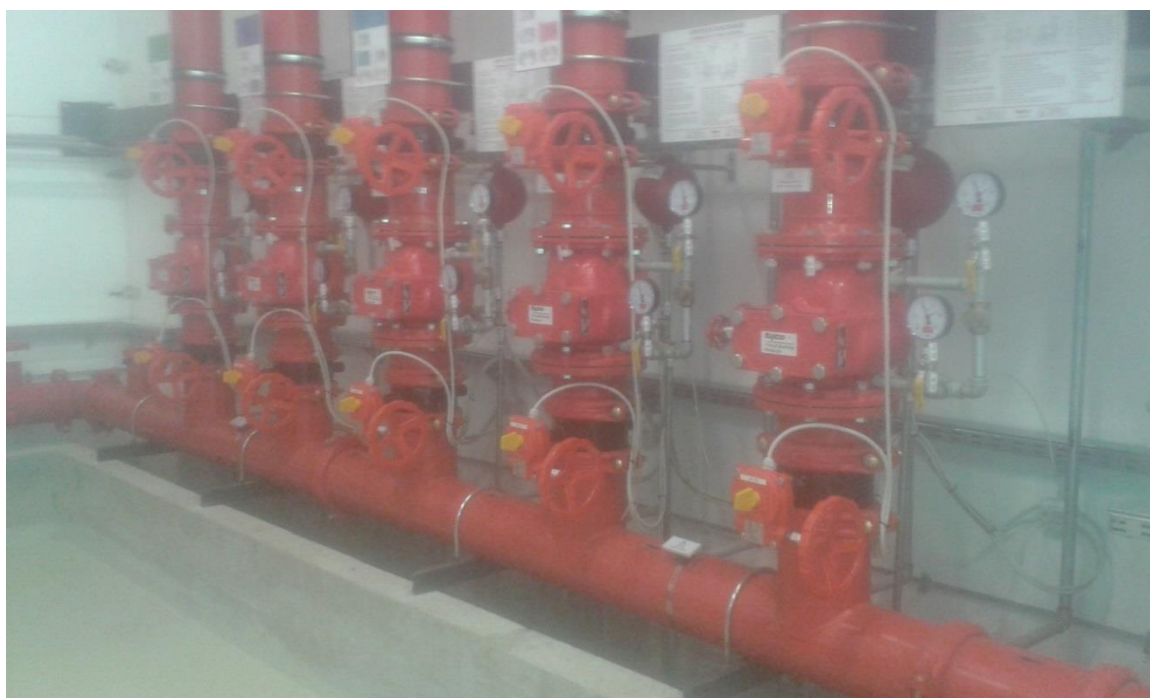
Slika 36. Ventilske stanice mokrog sprinkler sustava
