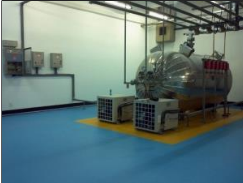
Slika 10. Spremnici medija za gašenje niskotlačnog CO 2 sustava [12]
