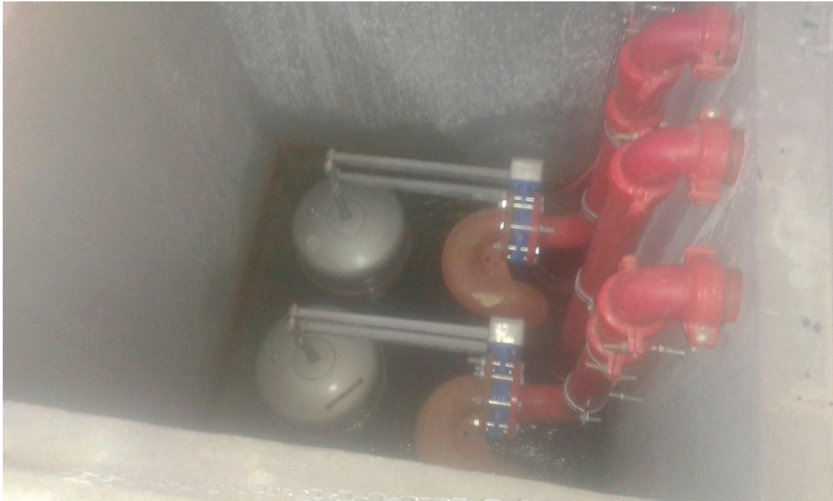
Slika 34. Spremnik vode za sprinkler instalaciju
