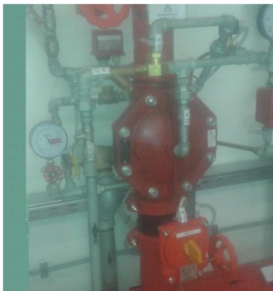
Slika 35. Ventilna stanica za deluge sustav
