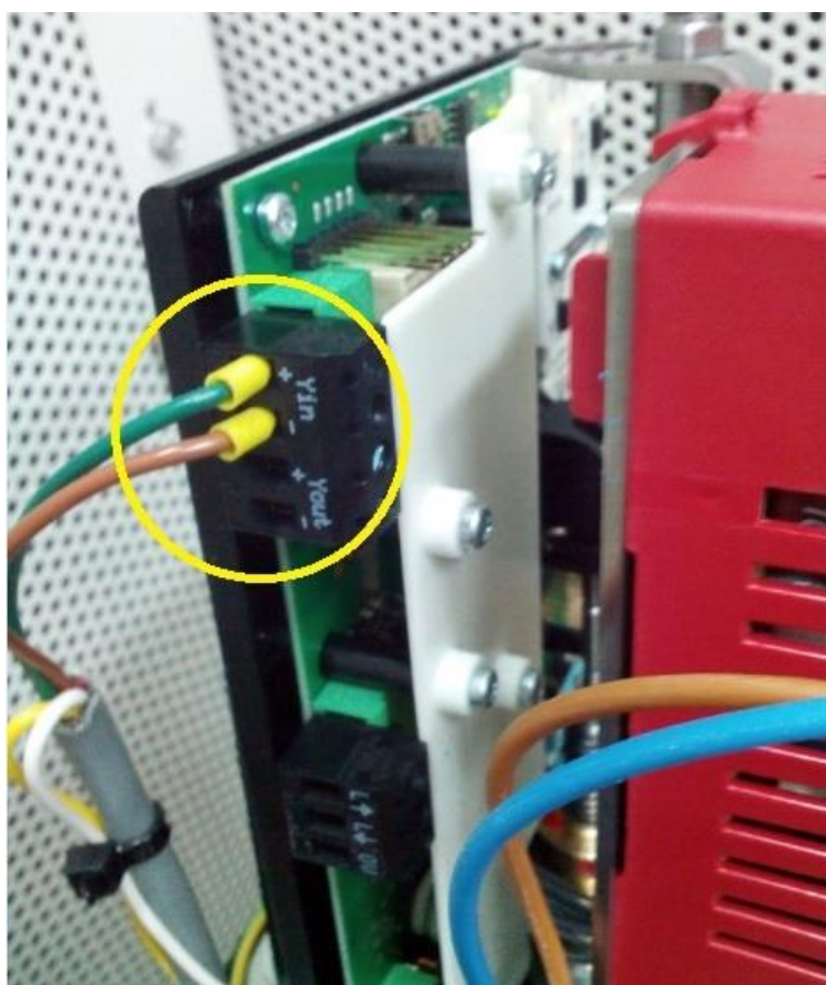
Slika 3.11. Spajanje signalnog kabla na aktuator.
