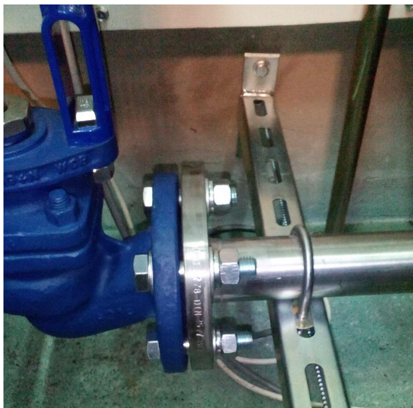
Slika 3.5. Vijčani spoj ventila i cijevi.
