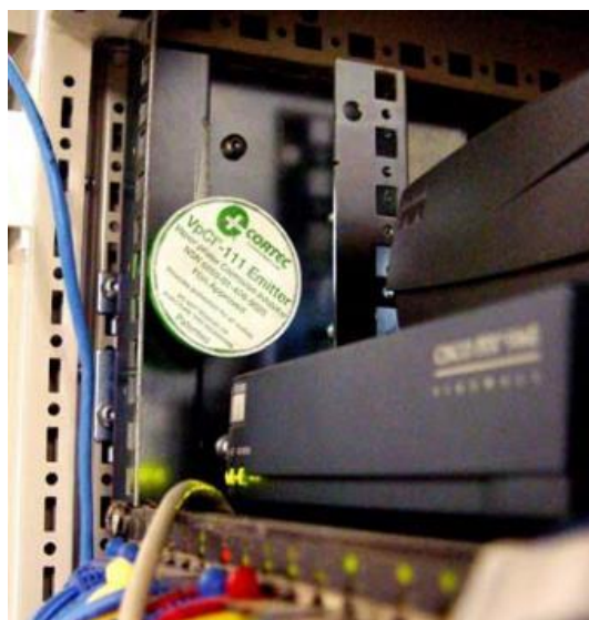
Slika 17. Primjena inhibitora za zaštitu metalnih dijelova u upravljačkim kutijama [14]
