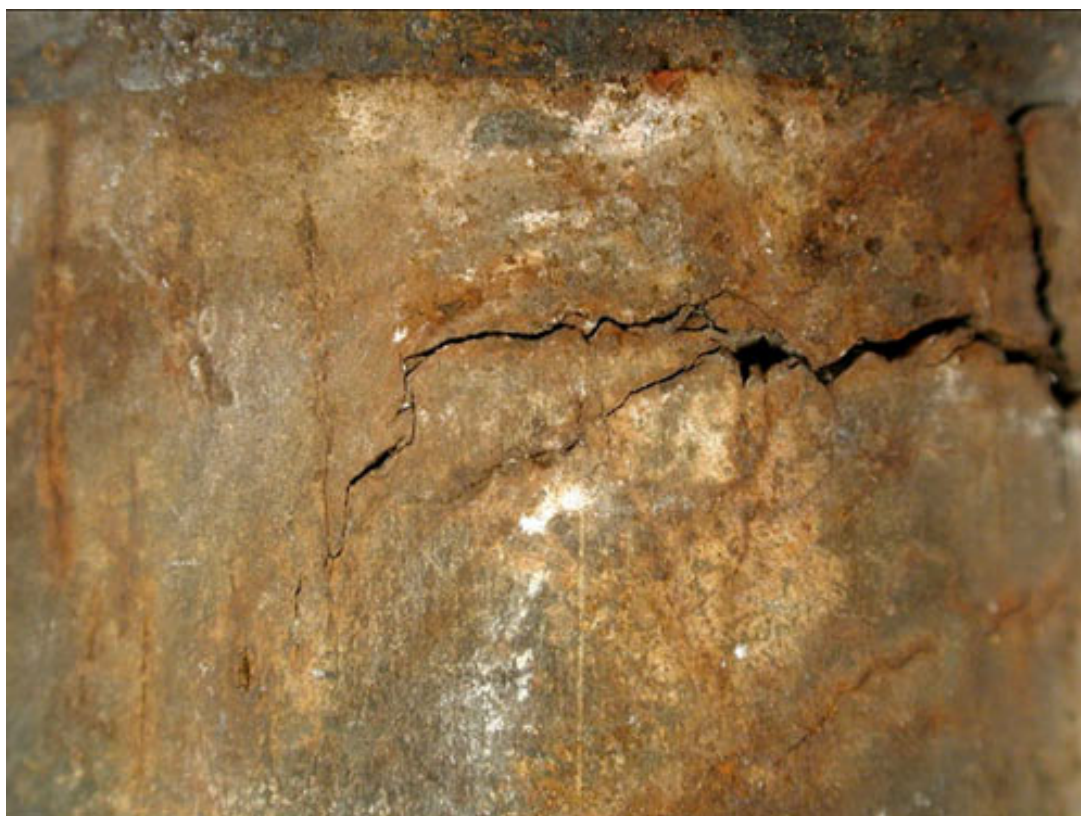
Slika 13. Austenitni nehrđajući čelik (316Ti) zahvaćen napetosnom korozijom [19]
