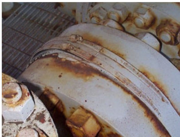
Slika 10. Korozija u procijepu [15]
