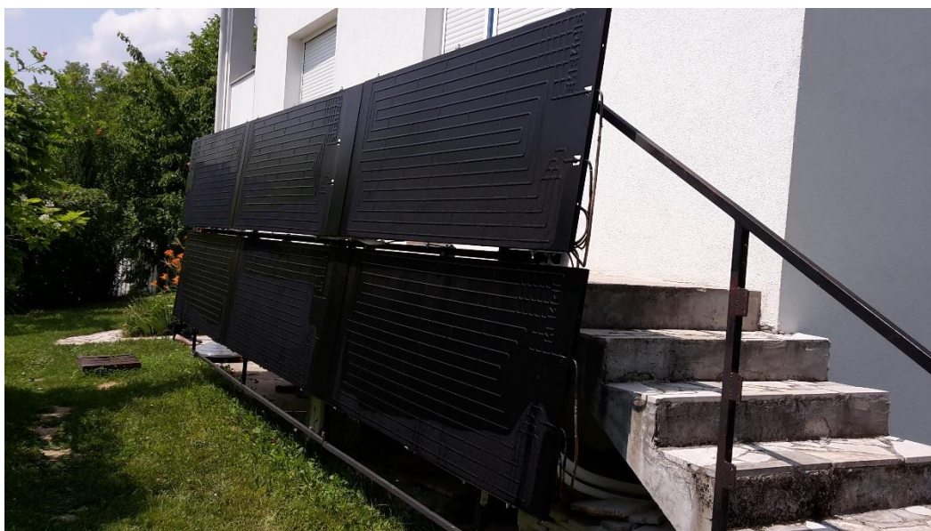
Slika 8. Kolektori ugrađenog sustava na lokaciji
