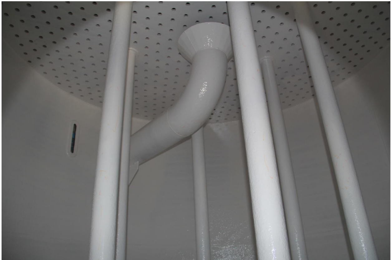
Slika 13. Unutrašnjost filtra za vodu za piće [22]
