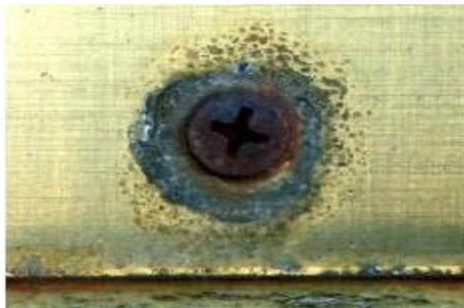
Slika 3. Primjer galvanske korozije [9]
