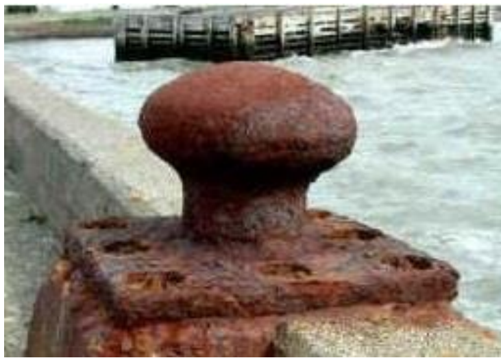
Slika 2. Primjer opće korozije [8]
