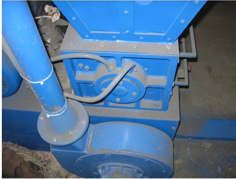
Slika 10: Ležaj u kućištu mlina i hlađen vodom
