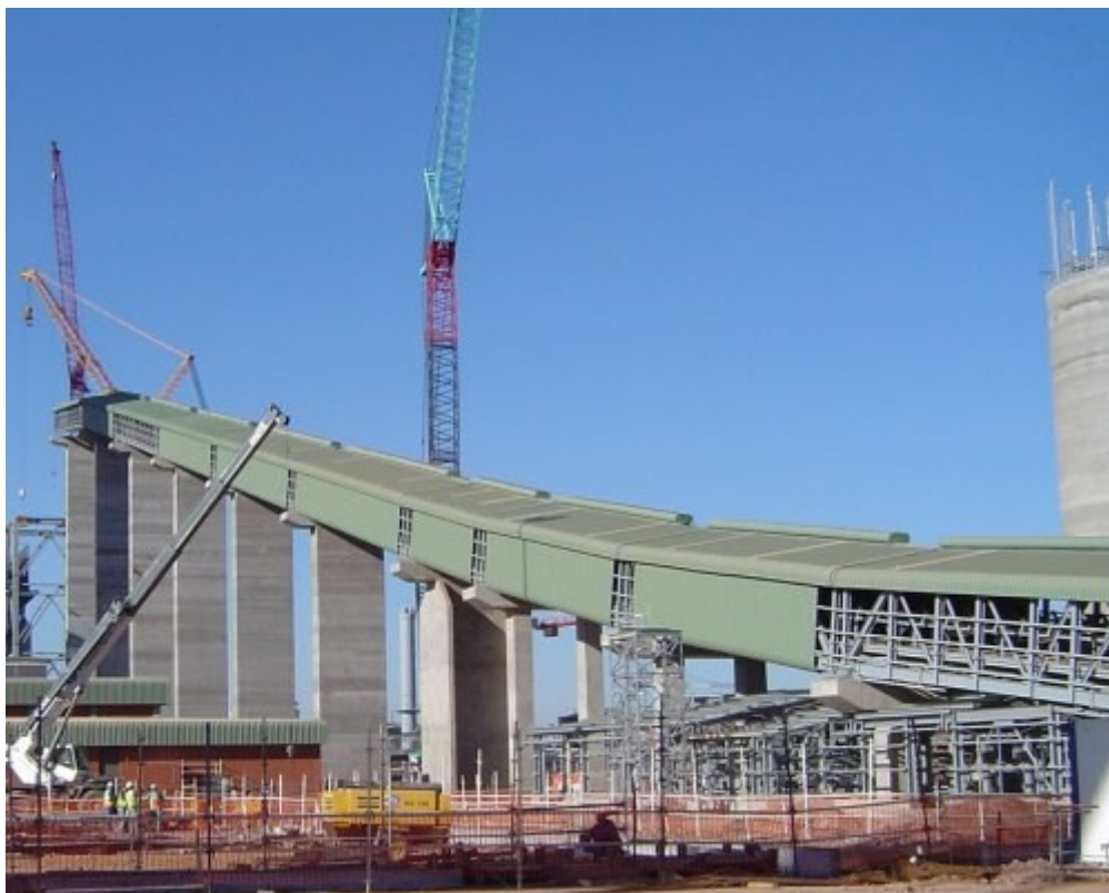
Slika 39. Konstrukcija za dovoz ugljena do kotla [21]
