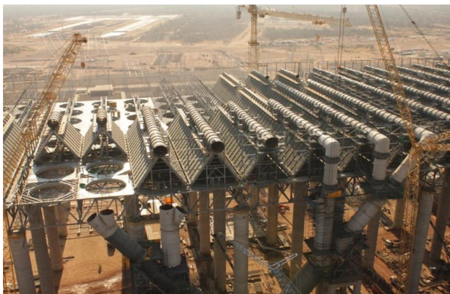
Slika 49. Prikaz izmjenjivačkih površina kondenzatora
