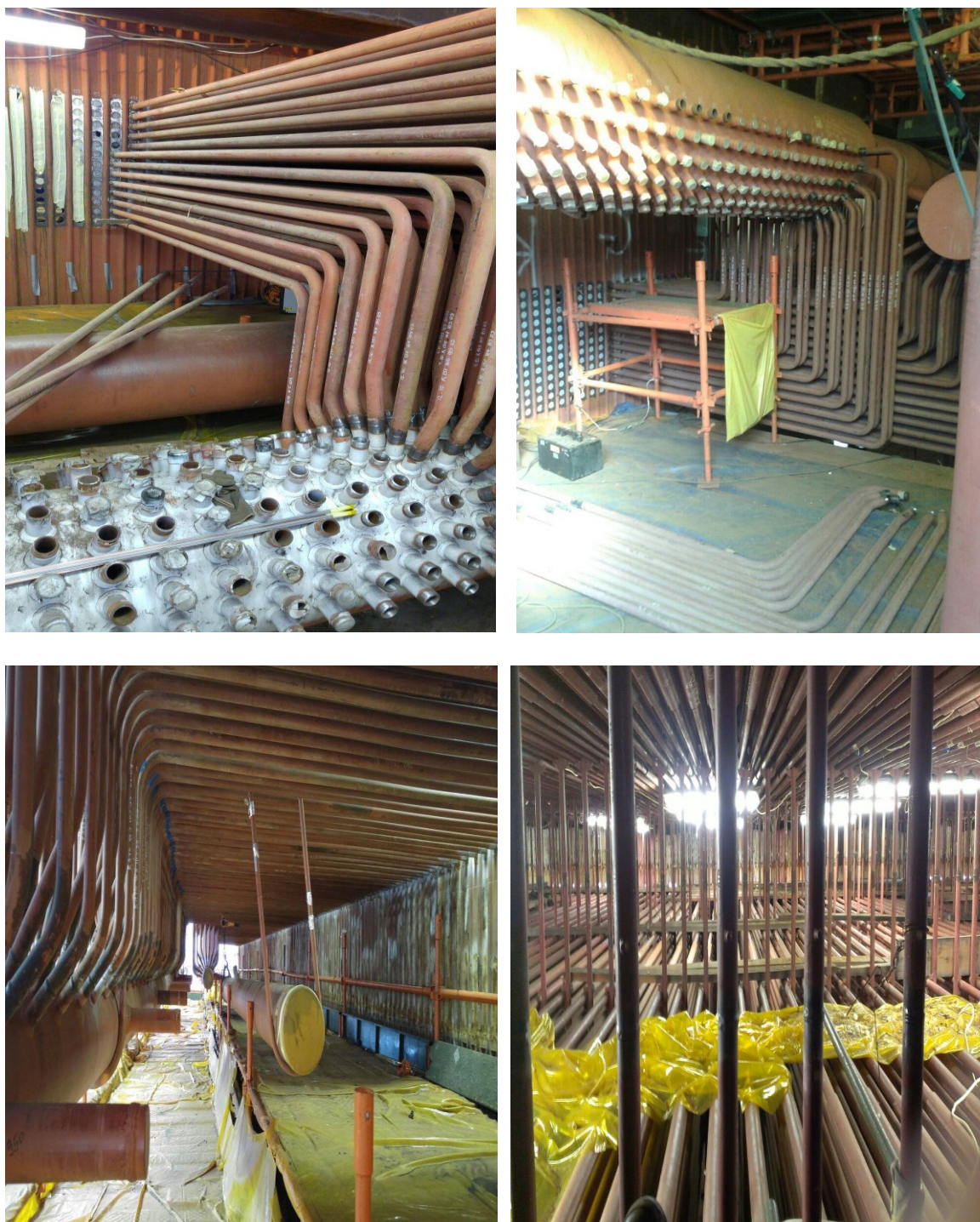
Slika 38. Izmjenjivačke površine i cijevi generatora pare
