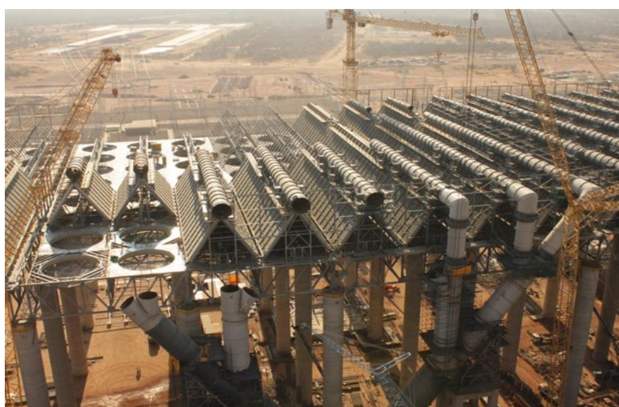
Slika 49. Prikaz izmjenjivačkih površina kondenzatora
