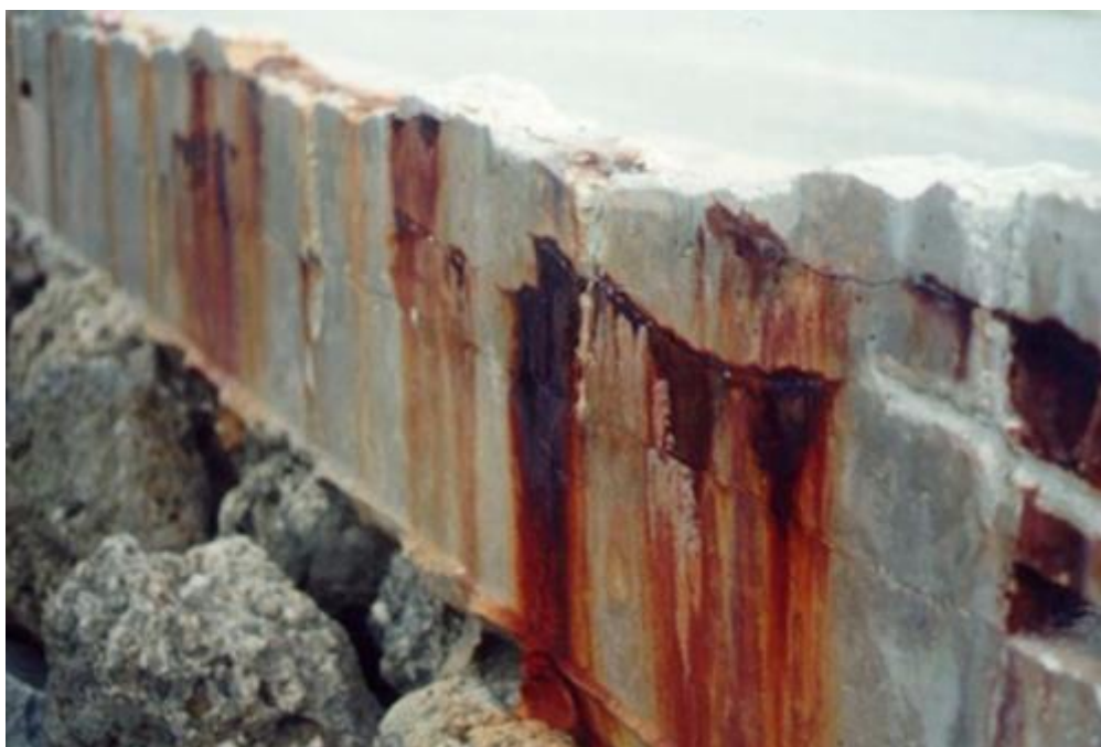
Slika 25. Korozija u morskoj atmosferi [21]
