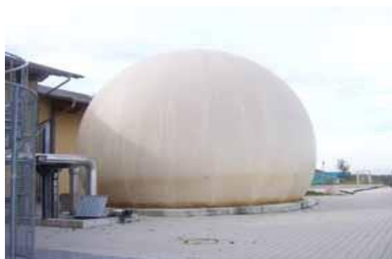
Slika 18. Vanjsko niskotlačno spremište za skladištenje plina.
