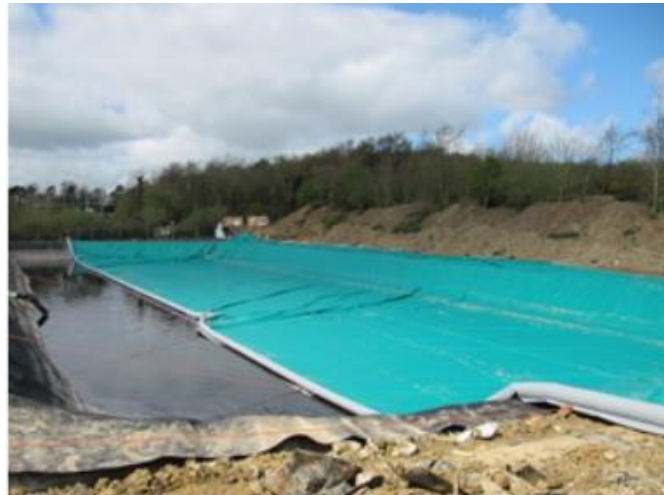
Slika 60. PVC pokrov spremnika digestata.
