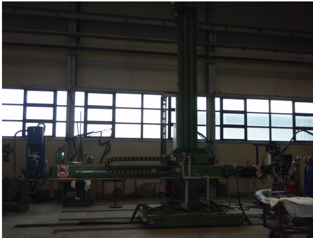
Slika 43. Konzolni nosač na stupu na kojem se nalazi oprema za EPP zavarivanje [29]
