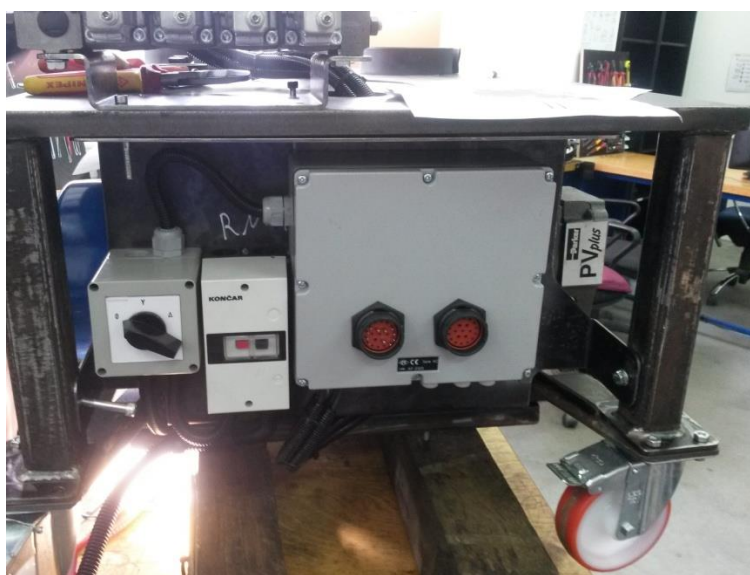
Slika 34. Elektroormar sa pripadajućim sklopkama
