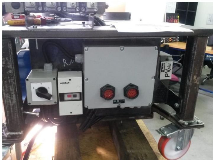
Slika 11. Elektroormar sa pripadajućim sklopkama
