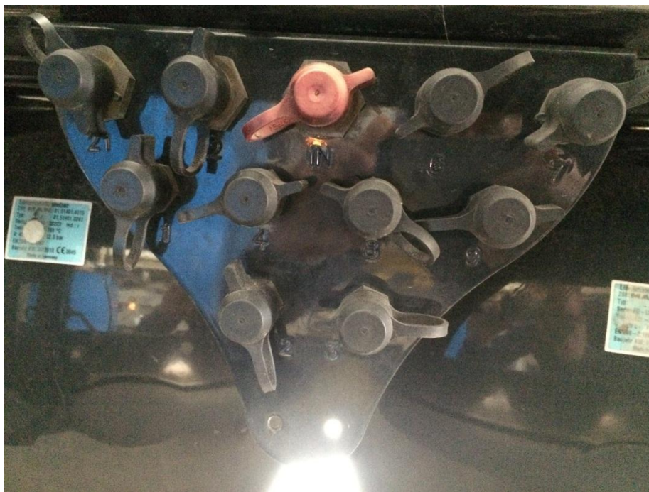
Slika 51. Kontrolni priključci spremnika zraka
