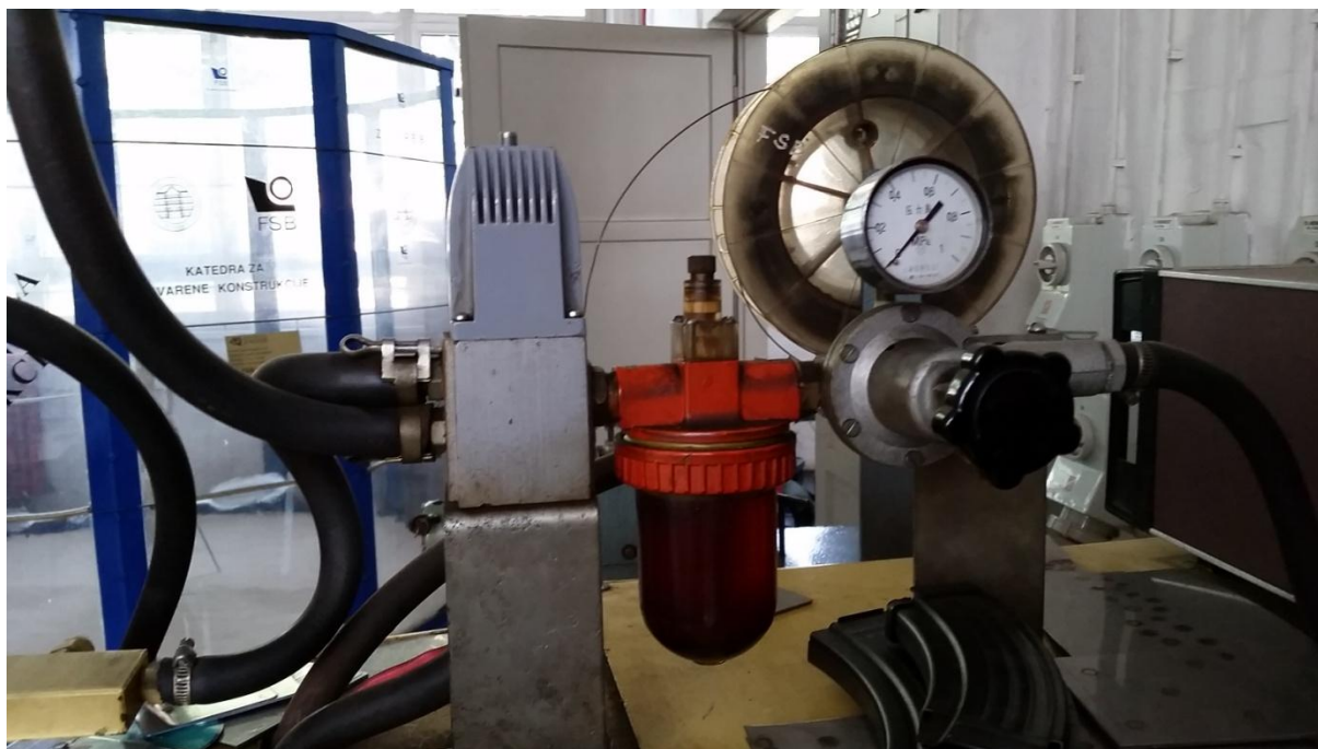
Slika 24. Manometar, nauljivač i elektromagnetski razvodnik
